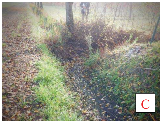
FIG. 12: FOSSATO SUL CONFINE EST A) SPIGOLO SUD EST; B SVILUPPO; C) SPIGOLO NORD EST (IMMISSIONE NEL FOSSATO LATO NORD
