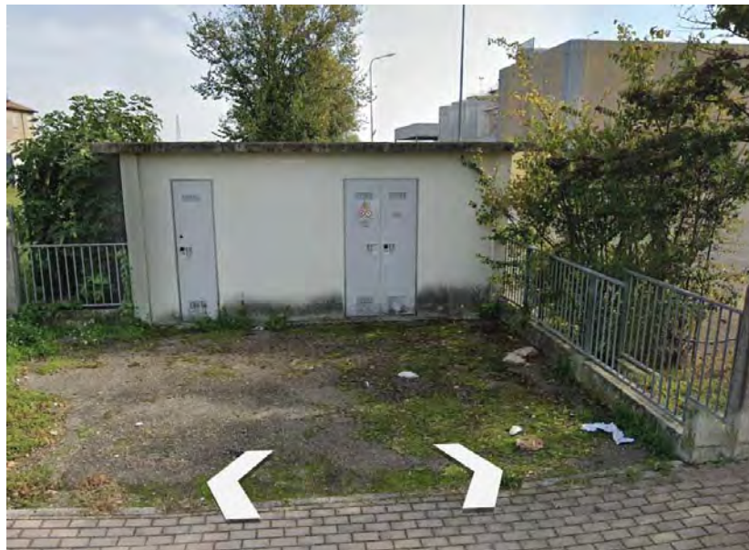
Fig. 3.43 – cabina di trasformazione secondaria MT/BT a servizio della cantina (ggogle street view)
