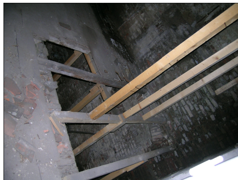
PAVIMENTO CROLLATO NORD
