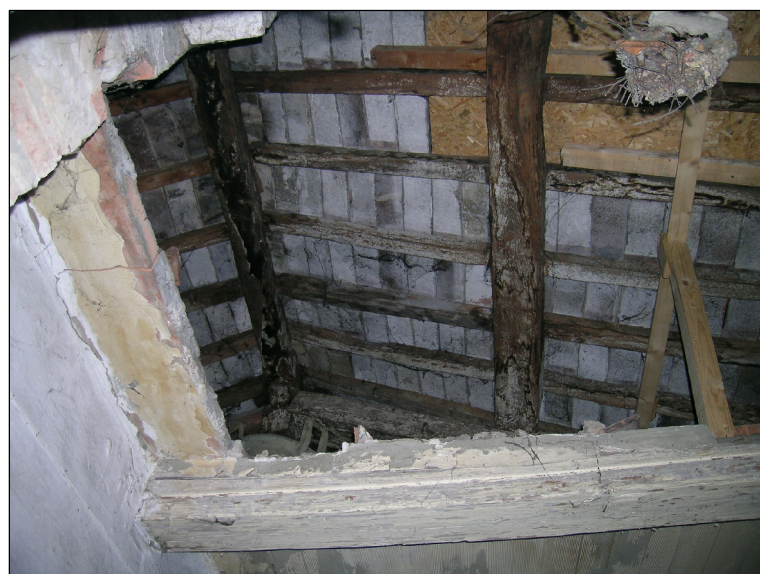
SOFFITTO CROLLATO SUD
