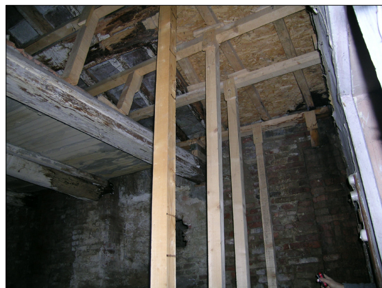
SOFFITTO CROLLATO NORD
