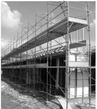
esempio di ponteggio in cui il tirante d'aria (T) deve essere garantito, in particolare, nel lato interno al fine di preservare gli operatori da eventuali cadute sui ferri di ripresa
