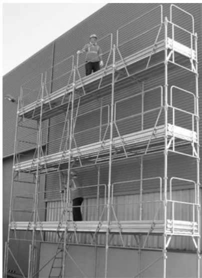
ponteggio provvisto di parapetti permanenti - protezione collettiva (fonte www.edilio.it )
